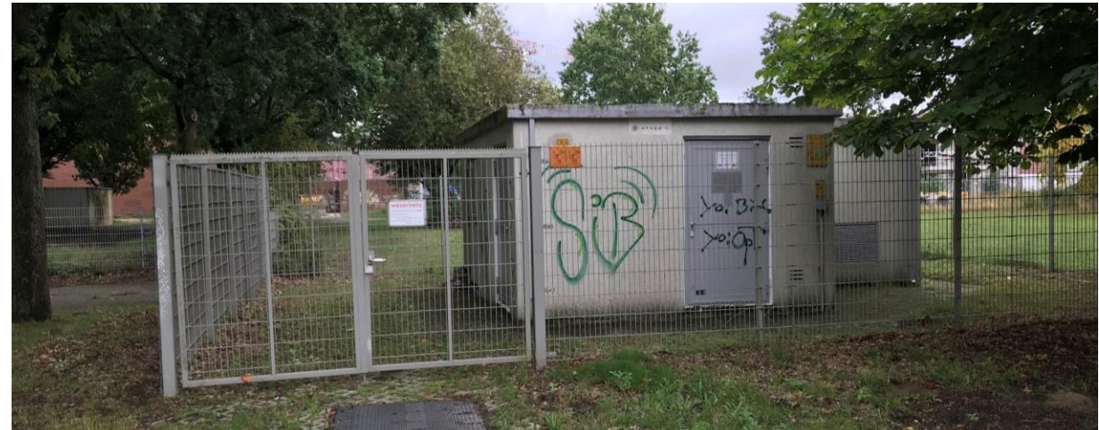
Gasdruckregelstation / Trafo und Leitungen
